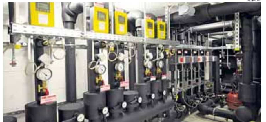
Im Testlabor von T-Systems in München – hier der Versorgungsraum – geht es auch um die Steigerung der Energie-Effizienz in Rechenzentren
