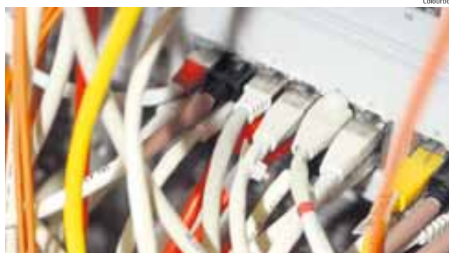
Der Kabelsalat könnte schon bald Vergangenheit sein
