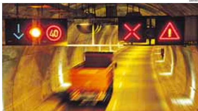
Siemens will die Sicherheit in Straßentunnels erhöhen
