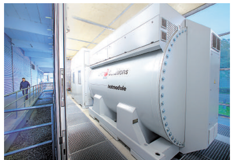
T-Systems nutzt erstmals weltweit eine Biogas-Brennstoffzelle im Dauerbetrieb für ein Rechenzentrum. Foto: T-Systems
