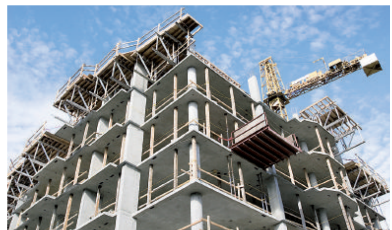
Moderne Gebäude verfügen über eine Vielzahl von miteinander verknüpften Infrastruktursystemen. Foto: iStockphoto.com
